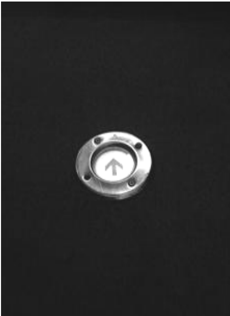
객석 게이트 앞 유도등
