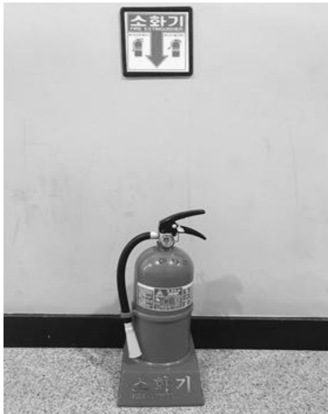
소화기 및 소화기 표지판
